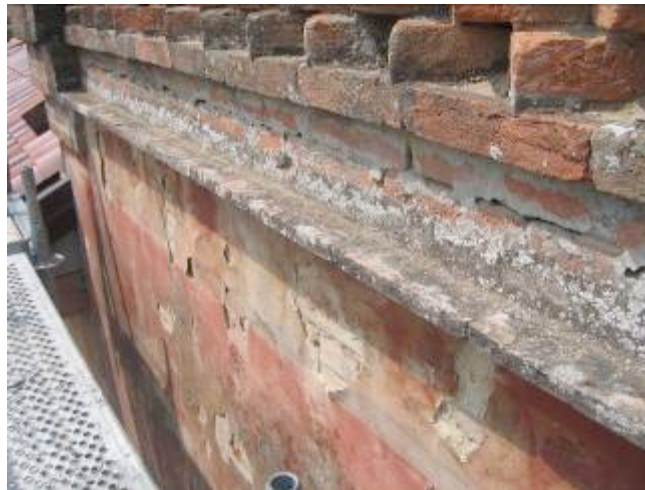
Figura 6.Porzioni di intonaco ammalorate e rigonfiamenti
